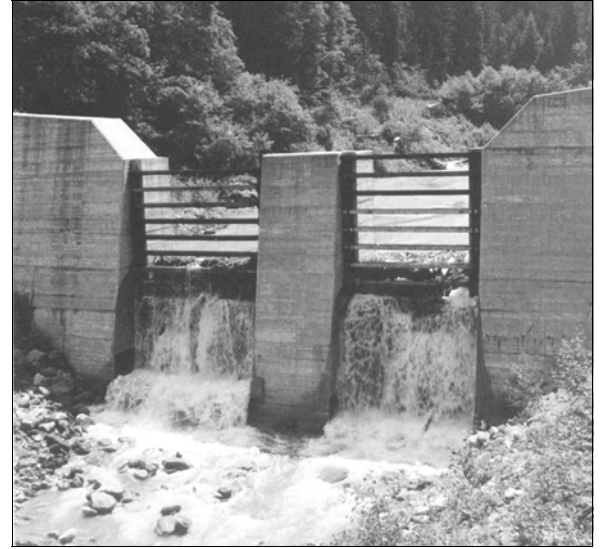
Slika 6-7: Prebiralna pregrada na hudourniku
