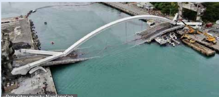
Porušitev mostu Nanfang'ao
