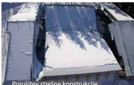
Porušitev strešne konstrukcije
