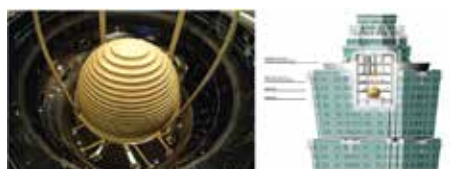
Upornik zoper močnih vetrov in potresnih sunkov v stavbi Taipei 101
