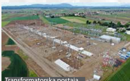
Transformatorska postaja Cirkovce
