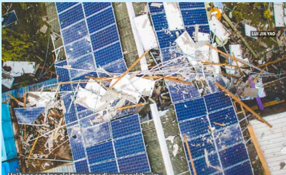
Uničene sončne elektrarn zaradi vremenskih ujm
