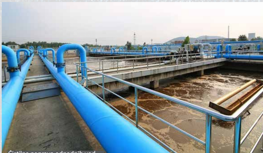
Čistilna naprava odpadnih vod
