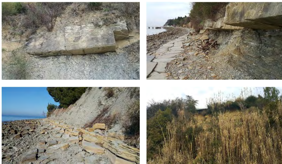
Slika 4.6: Spodkopavanje blokov peščenjaka z manjšim že izpadlim blokom na desni strani (levo zgoraj), izrazito spodkopana in štrleča plast peščenjaka na Debelem rtiču (desno zgoraj), izpadli bloki peščenjaka na vznožju (levo spodaj), spodkopana terasa stanovanjskega objekta pri Gradisu zahodno od Ankarana (desno spodaj).
