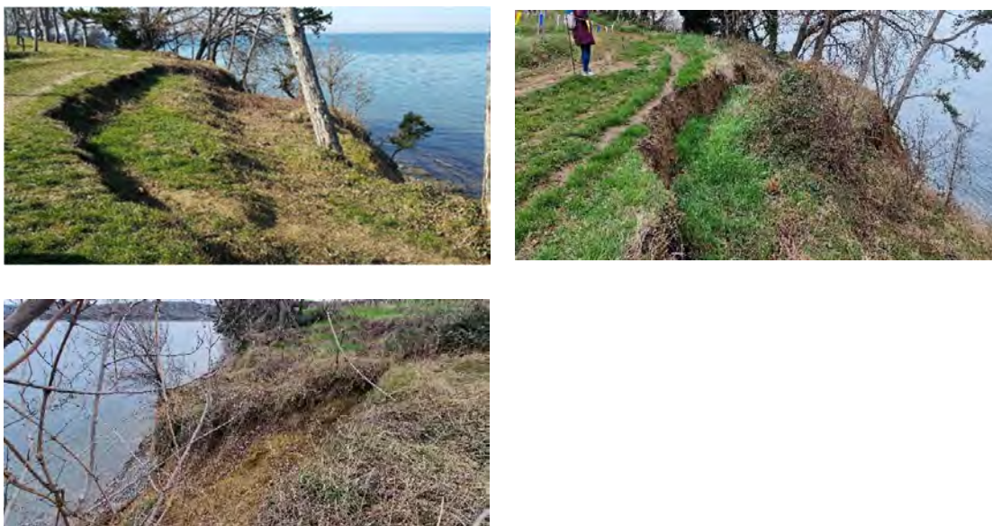
Slika 4.8: Levo zgoraj: odlomni rob na Debelem rtiču leta 2022. Desno zgoraj: ista lokacija z večjim premikom oz. posedanjem, območje proti obali je že splazelo. Levo spodaj: manjši zemeljski plaz na isti lokaciji.
