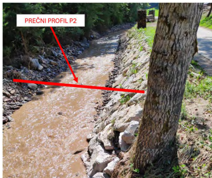
Slika 9.64: Stanje po poplavni ujmi na odseku Hrastnice v bližini prečnega profila P2 – pogled gorvodno (Foto: T. Dolenc, avgust 2023).
