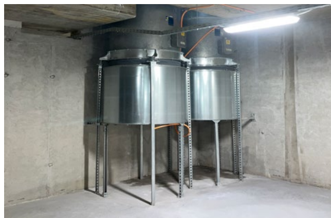
Slika 2: Ventilator izhodne odprtine
