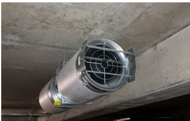
Slika 1: Primer vgrajenega potisnega ventilatorja AJR 355 v garaži
